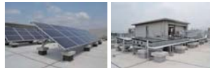
太陽光発電パネル(左)・太陽熱温水パネル(右) 屋上 太陽光で発電、太陽熱で給湯し、省エネルギーに貢献します。
