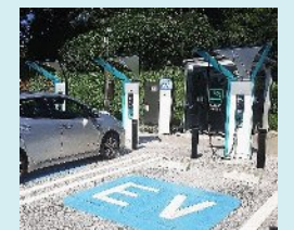
EV充電スタンド
