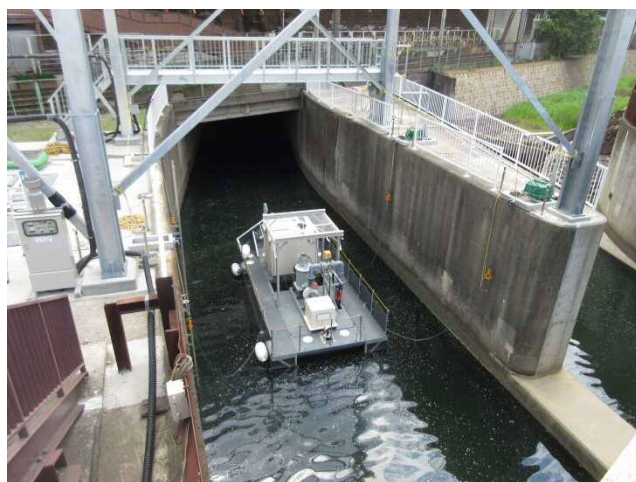
装置稼働状況(王子桜橋上流右岸側)
