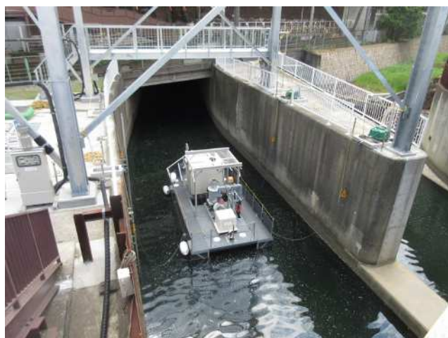
装置稼働状況(王子桜橋上流右岸側)
