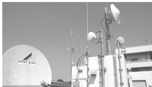
防災行政無線の通信アンテナ
