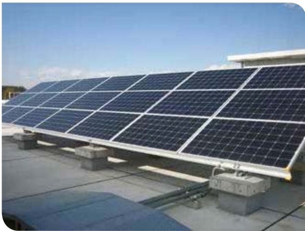
太陽光発電（中学校屋上設置）
