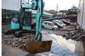
液状化で地盤が陥没した新潟西郵便局の駐車場。(写真：日経クロステック)
