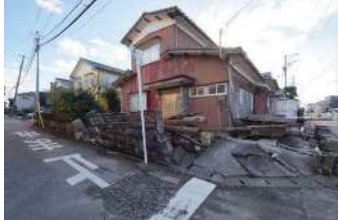
液状化の被害があった新潟県新潟市西区の住宅。(写真：建物修復支援ネットワーク)
